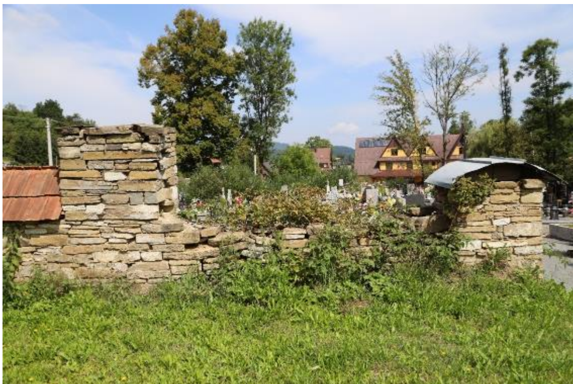
Il. 79 Pozostałości przykościelnego muru zachowane w miejscu dawnego kościoła, z uszkodzonymi kapliczkami.
