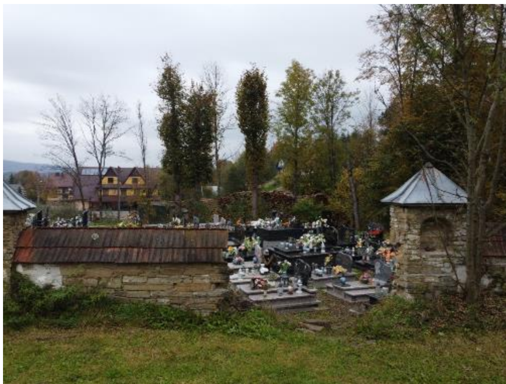
Il. 78 Fragment kościelnego muru (częściowo wyburzonego) z uszkodzoną kapliczką, przy której wyrasta młode drzewo.
